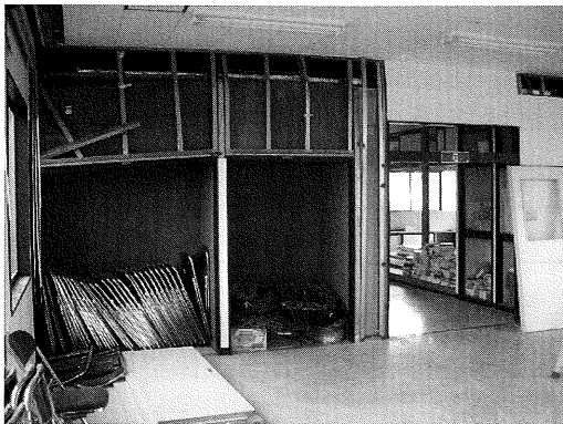
▲2F会議室の壁が破損。(志波姫支所)
