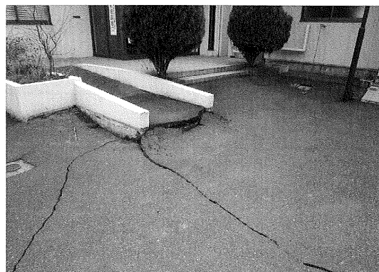
▲玄関前の地盤沈下 (高清水支所)
