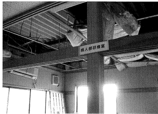
▲天井が抜けました。(志波姫支所)
